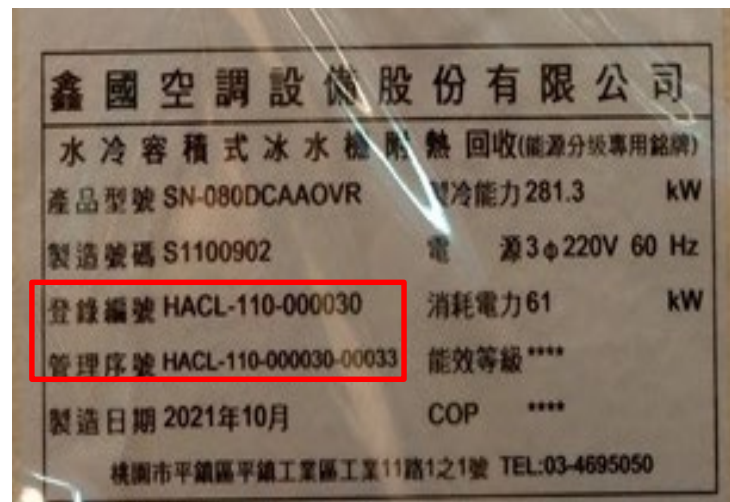
具熱回收冰水機組
