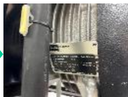
壓縮機銘牌檢查
