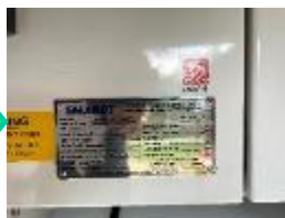
機組銘牌檢查
